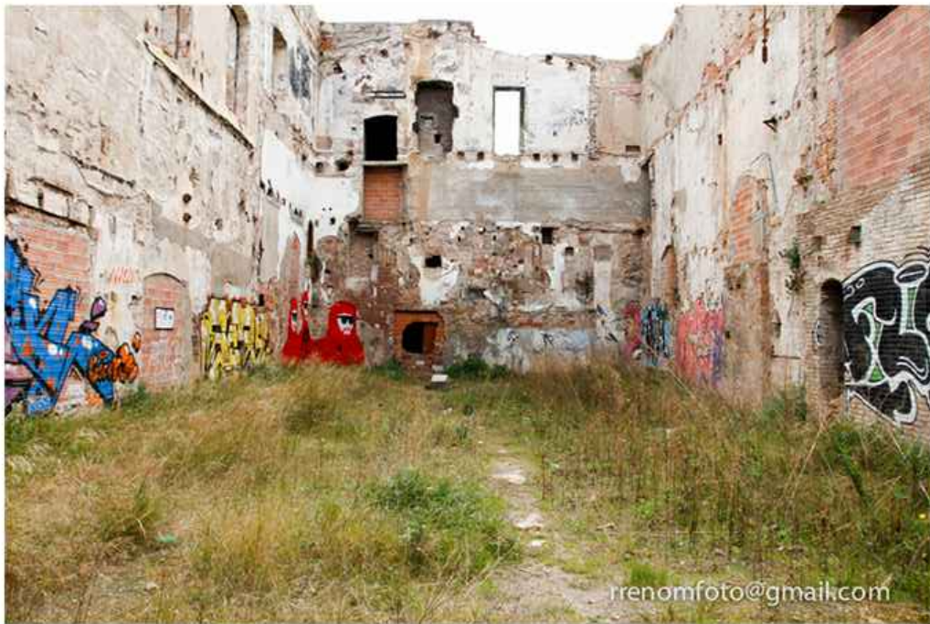
FOTO 1 : ZONA 1,2 | 7 FAÇANA POSTERIOR COS PRINCIPAL
